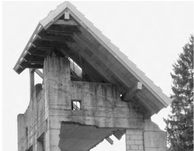
Schrägdach auf der Mehrzweckstation im Ohrbühl
